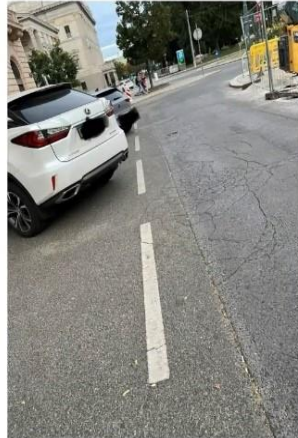
Sind auf dem Bild Straßenschäden zu
